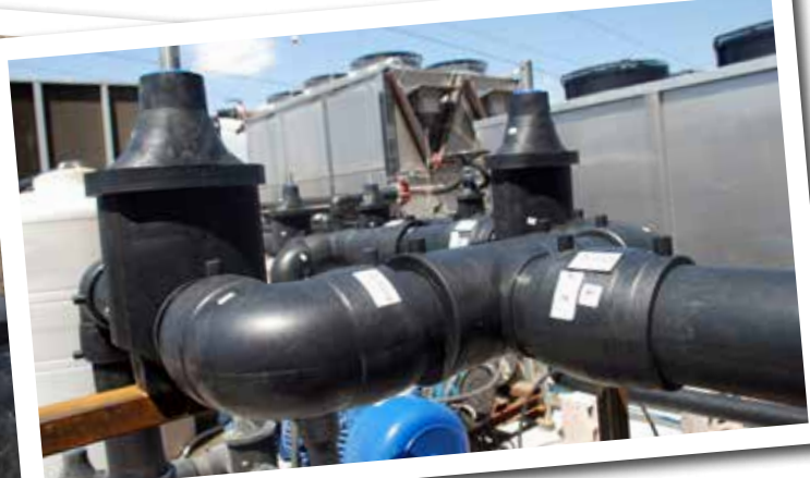
Türkiye - Soğutma Sistemi Turkey - Cooling System
